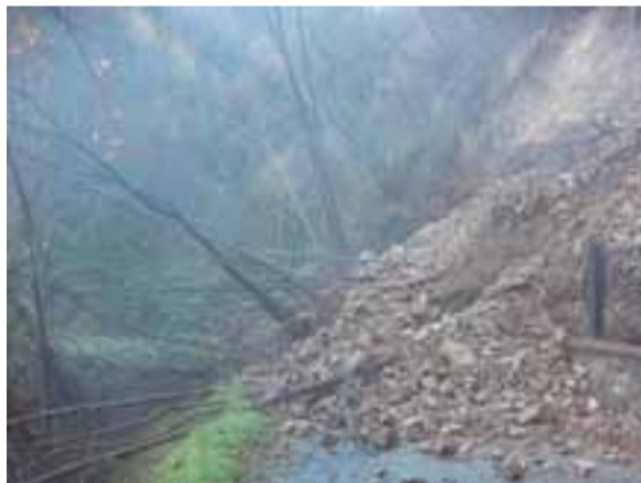
Frana in loc. Lezzarelle.
